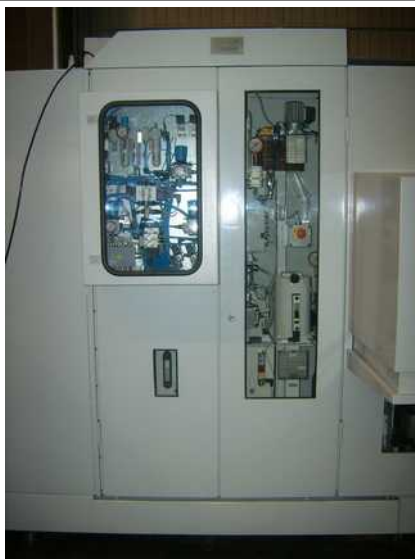
Impianto idraulico e pneumatico
